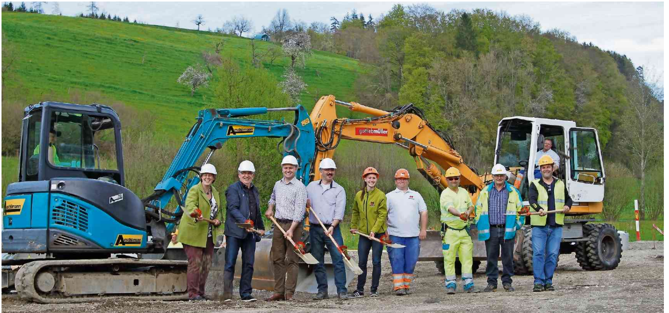
Mit goldenen Schaufeln wurde der Spatenstich durchgeführt (v. l.): Franziska Jud, Inhaberin F. Jud Architektur AG, Beat Bättig, Remax Immobilien, Reto Müller und Marco Borner, beides GL-Mitglieder der Jud Architektur AG, Seraina Hochuli, Martin Buchmüller von der Gottlieb Müller AG sowie Stefan Klasnic, Hans Schmidlin und Jan Borer der Firma Aeschlimann AG.
